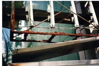
↑看板底部の脱落
