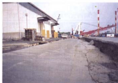
写真-Ⅱ.2.57 ケーソンの沈下、滑動による 背後エプロンの陥没 (尼崎西宮芦屋港西宮地区岸壁(-5.5m))
