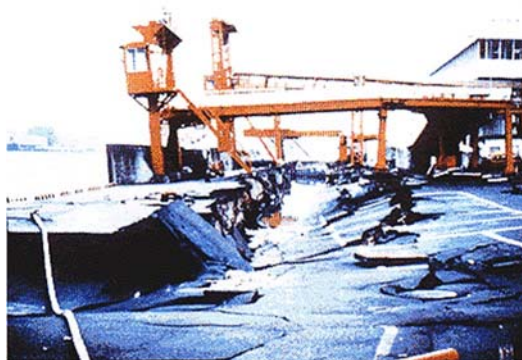
写真 神戸港被災写真(六甲アイランド地区)
