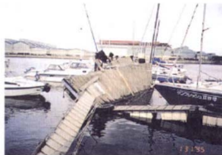
写真-Ⅱ.2.61 杭、係留船舶との衝突による 破壊 (西宮ヨットハーバー浮棧橋)
