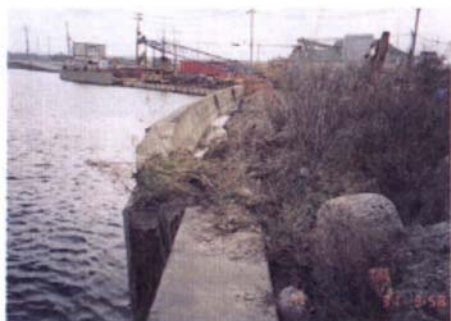
写真-Ⅱ.2.54 鋼矢板護岸の被災 (尼崎西宮芦屋港尼崎地区)
