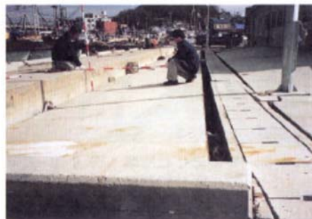
写真-Ⅱ.2.65 背後エプロンの沈下 (岩屋港物揚場(-2.0m))
