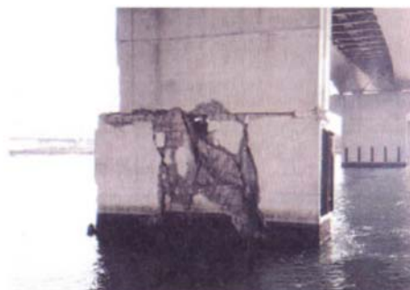
写真-Ⅱ.2.55 強い水平力によるせん断破壊 (尼崎西宮芦屋港西宮地区西宮大橋)
