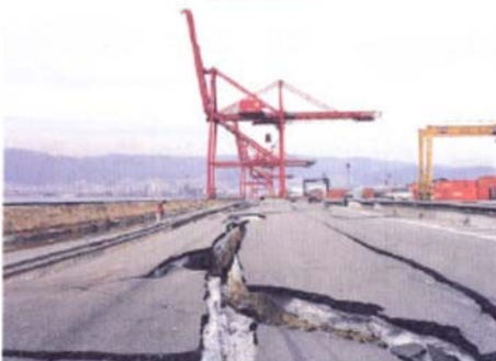
写真-Ⅱ. 2. 71 六甲アイランドコンテナヤードの被災状況
