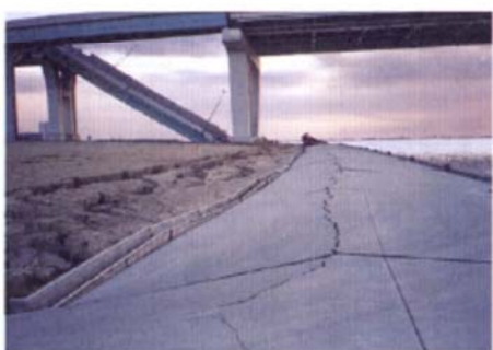
写真-Ⅱ.2.58 物揚場背後17°の部の沈下 (尼崎西宮芦屋港甲子園沖地区)
