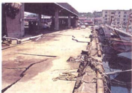
写真-Ⅱ.2.56 全体的に海側へ約70cm せり出した物揚場(-2.0m) (室津港)
