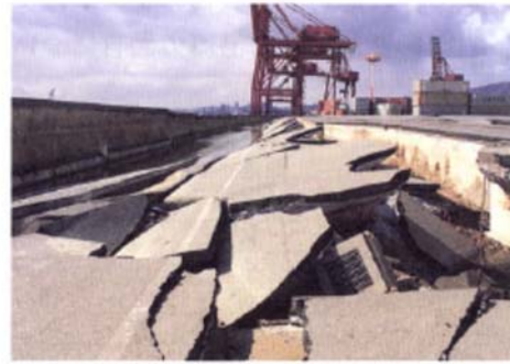
写真-Ⅱ. 2. 67 摩耶コンテナターミナルの被災状況
