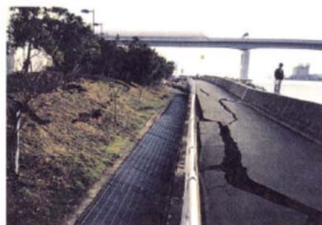
写真-Ⅱ.2.63 護岸本体の沈下 (尼崎西宮芦屋港芦屋地区)
