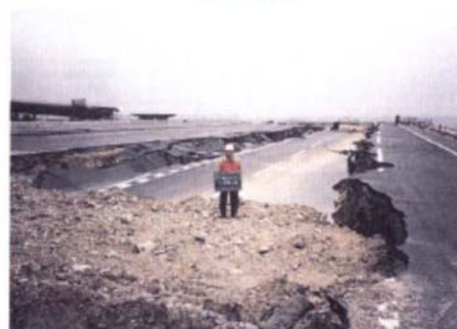
写真-Ⅱ. 2. 72 前面ケーソン沈下による背後エプロンの陥没（六甲アイランド）
