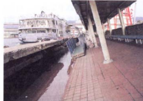
写真-Ⅱ. 2. 70 中突堤旅客ターミナルの被災状況
