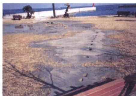
写真-Ⅱ.2.59 緑地の液状化による噴砂状況 (洲本港中浜地区)
