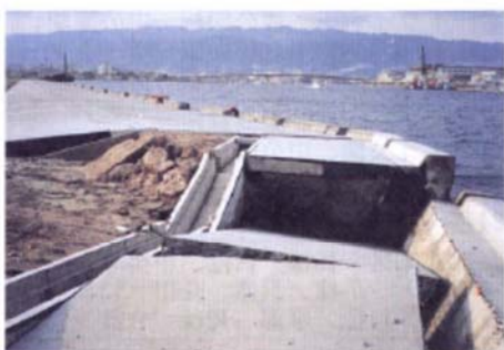
写真-Ⅱ.2.62 前面ブロックの傾斜による 背後エプロンの陥没 (尼崎西宮芦屋港甲子園地区物揚場(-4.0m))
