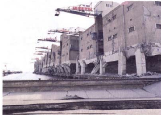
写真-Ⅱ. 2. 68 新港第8突堤西側の被災状況
