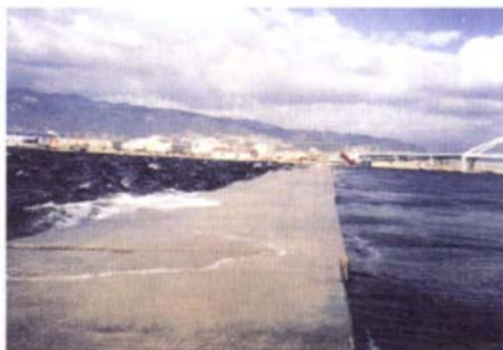
写真-Ⅱ.2.60 ケーソンの沈下による水没 (尼崎西宮芦屋港西宮地区防波堤)
