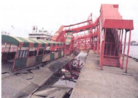
写真-Ⅱ. 2. 69 東神戸フェリー埠頭の被災状況
