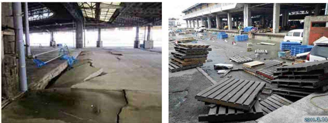
図 24 魚市場被災状況
