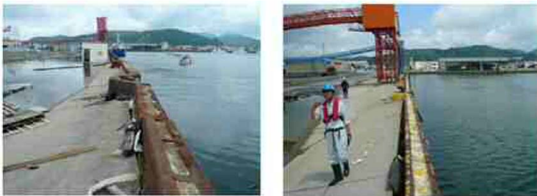
図 35 石巻漁港 -6.0m岸壁付近被災状況
