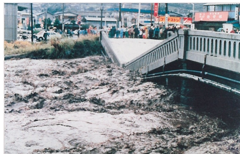
県道富士宮由比線野中橋 富士宮市野中東町 被災状況
