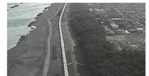
焼津市における静岡モデル防潮堤【潮風グリーンウォーク】
