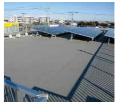
本社屋上の太陽光発電
