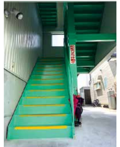
工場屋上への避難階段。地域住民も避難できるよう外階段となっている
