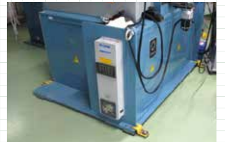
工場内設備を固定し転倒を防止
