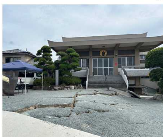
地面のひび割れ
