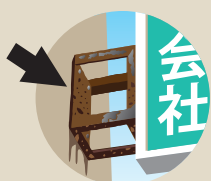
ブラケットの腐食
