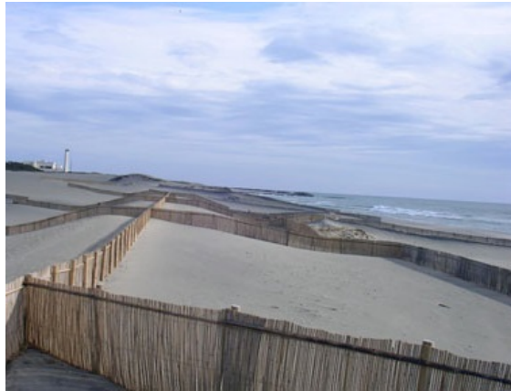
3-B 砂浜の侵食を防ぐため、堆砂垣の整備や養浜を行い、砂浜の維持に努めている。（遠州海岸、磐田市）
