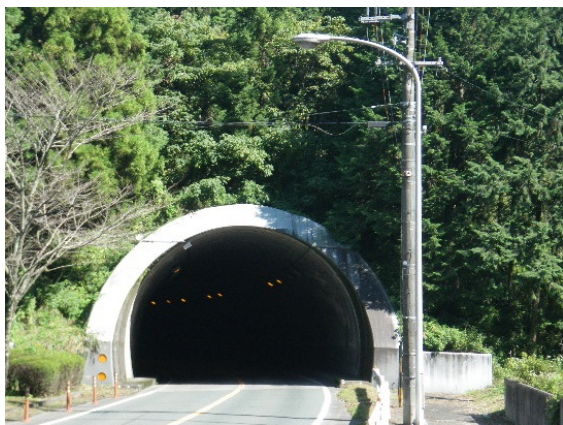
4-A 坑口部周辺の緑化により、周辺の自然景観と調和している事例。
