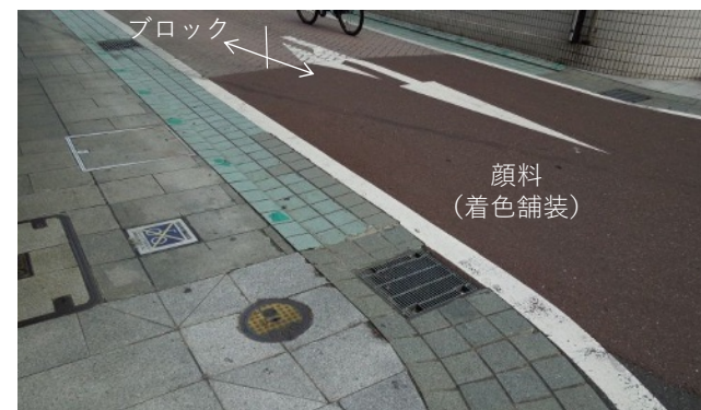
a)同じ道路の手前と奥で、ブロック舗装と着色舗装が使われており、連続性がなく統一感のない印象を与える。
