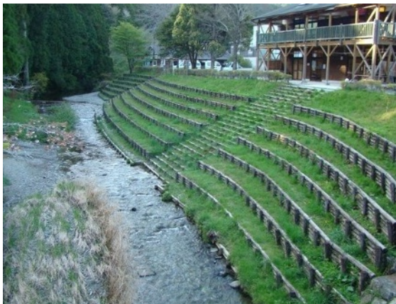
2-A 木柵を用いた緩やかな護岸中央には、水辺に降りる階段が護岸と同じ素材で整備されている。自然景観への調和と親水性を演出している。（気田川、浜松市）
