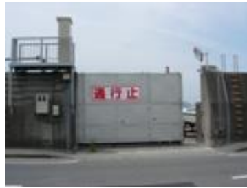
② 志下6号陸閘（沼津市志下）
