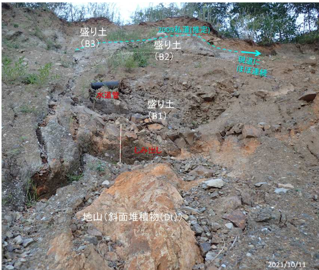
写真④ 左岸側崩落地の露頭
