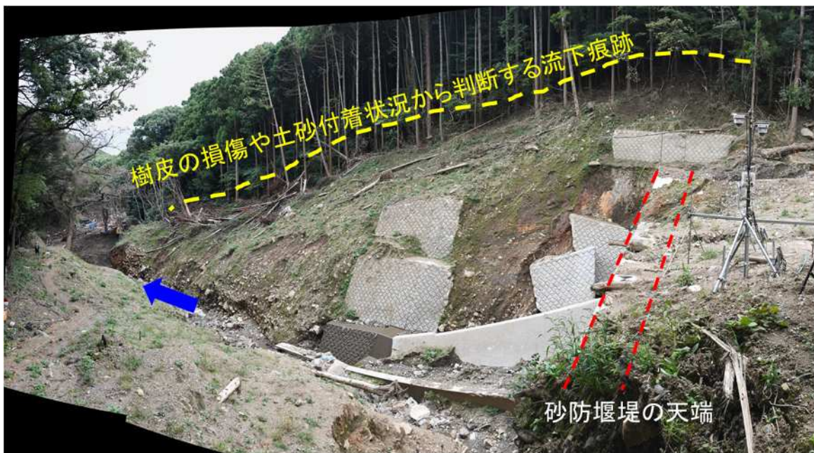
写真③ 砂防堰堤の下流右岸の流下痕跡
