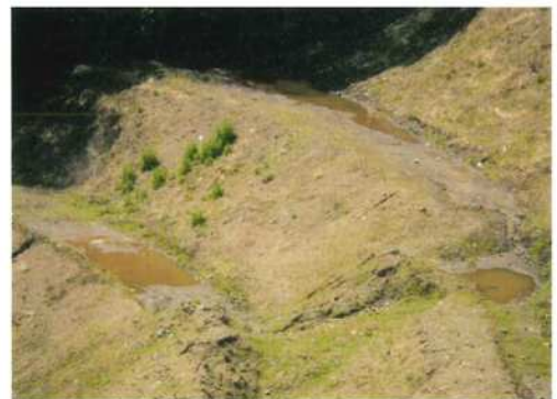
小段勾配の処理の悪さによる盛り土法面の水溜り
