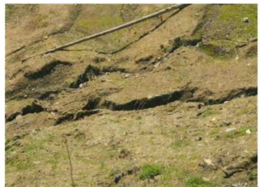
法面の浸食発達状況
