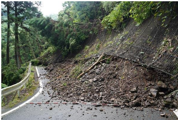
国道 362 号の土砂災害
