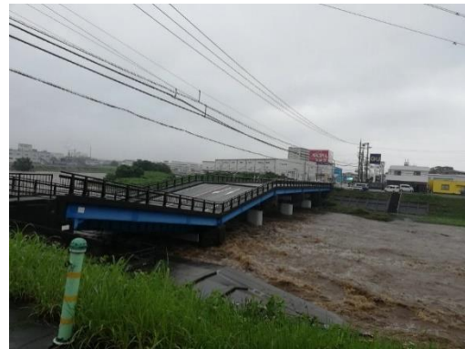
県道富士清水線(黄瀬川大橋)の被災
