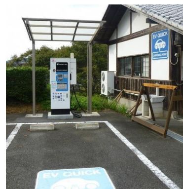
EV 充電施設
