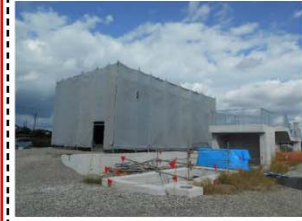
天王雨水ポンプ場
