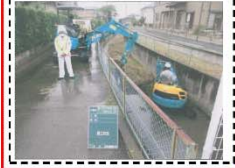
1-3 水路や道路側溝の浸透 排水路浸透状況 (他事例)
