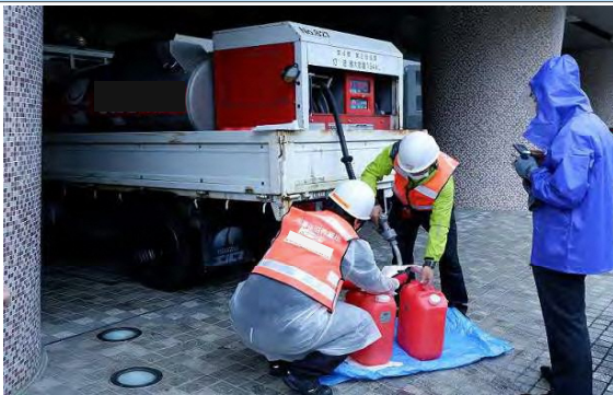
(自家発電機にホースが届かない場合) 153
