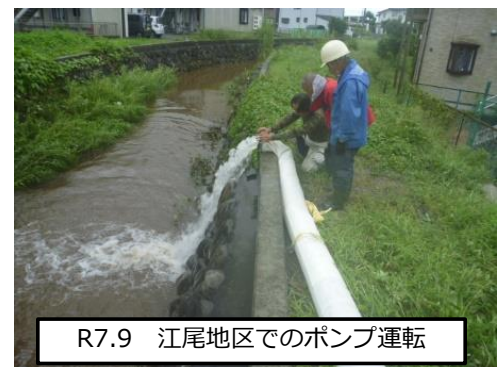
R7.9 江尾地区でのポンプ運転
