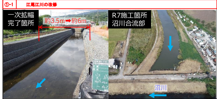
①-1 江尾江川の改修 河川整備計画に基づく河川改修(計画流量20m 3 /s)は、沼川合流部付近250mの築堤工事が完了した。また、整備効果早期発現のため、現河川の一次拡幅(計画流量約12m 3 /s)を実施。令和7年6月までに市道吉原沼津線権田給橋から約210mの一次拡幅が完了した。引き続き一次拡幅・築堤工事を実施していく予定である。(県)
