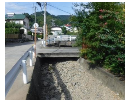
二級河川巴川流域の土砂流出状況 (静岡市葵区北)
