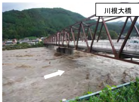
写真 2-8 平成 23 年 9 月台風 15 号洪水の状況
