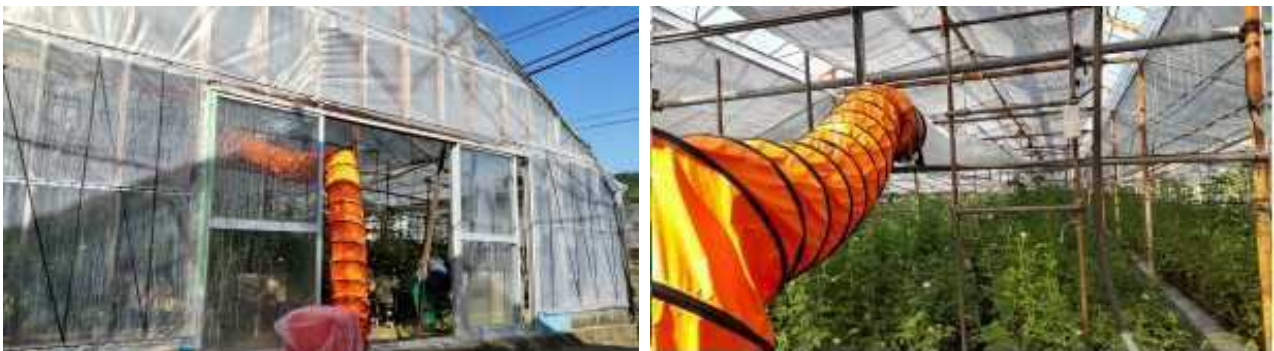
図1 外気導入の設置状況
