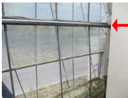
図1 ウォーターカーテン (寒冷紗取り外した状態、矢印のパイプから水が出る)
