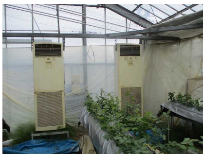
図2 ヒートポンプ
