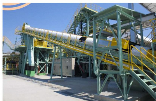
洗浄処理施設
