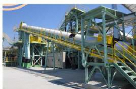
洗浄処理施設
