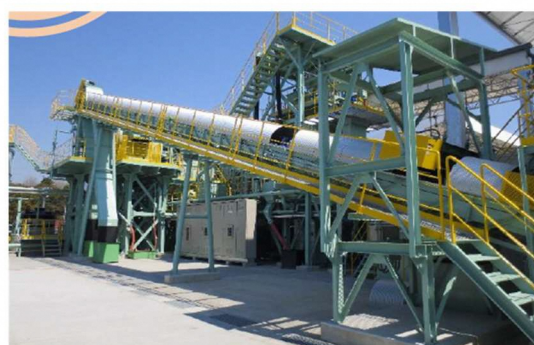
洗浄処理施設
