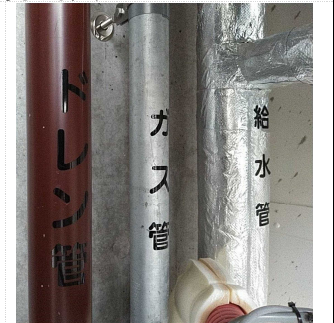
PS 内配管表示
