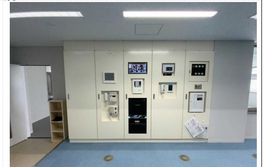
管制室 総合監視盤
