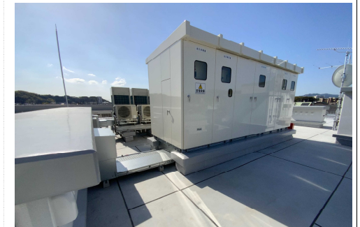
屋上 キュービクル
