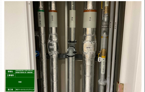
PS (パイプシャフト) 内配管
