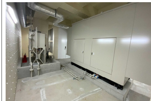
機械室 発電機
