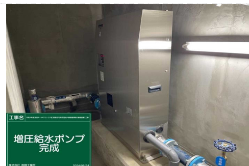
増圧給水ポンプ
