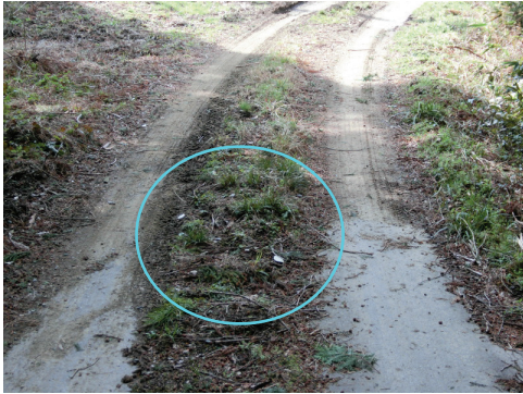
アスファルト上、自動車の轍（わだち）のあいだ部分に土が堆積し、ここを掘られている
