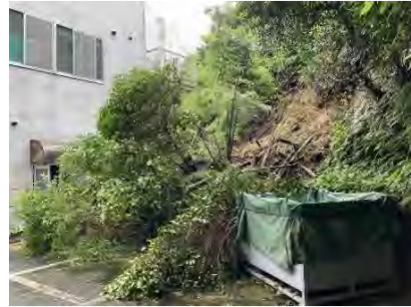
がけ崩れの状況 (湖西市鷺津)
