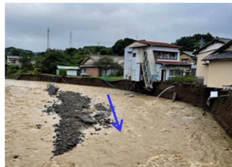
二級河川庵原川の護岸決壊 (静岡市清水区庵原町)
