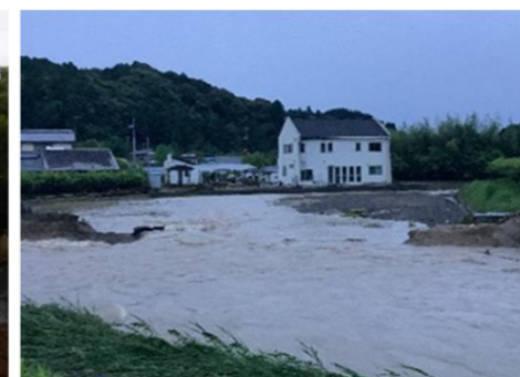
二級河川敷地川の破堤 (磐田市敷地)
