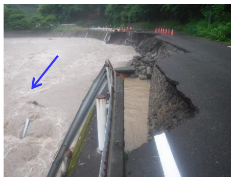
県道相俣岡部線の道路決壊 (藤枝市岡部町岡部)
