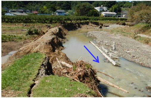
二級河川敷地川の破堤 (磐田市敷地)
