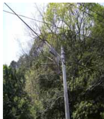
▲ 通信ケーブルの被害
