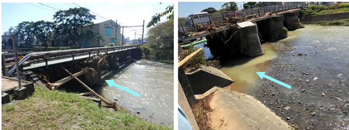
図 3-8 令和4年9月洪水によるJR橋梁・国道1号橋梁の浸水状況写真
