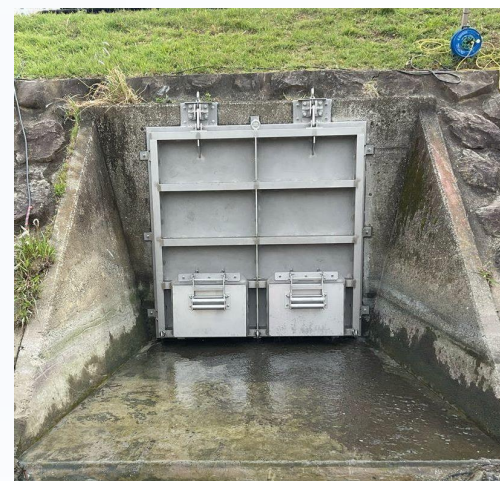
逆流防止施設設置状況 (横砂覆盆子雨水管)
