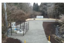
水源揚水井戸（御殿場市）
