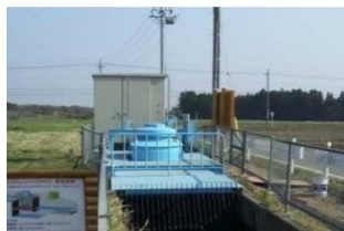
小水力発電所の整備
