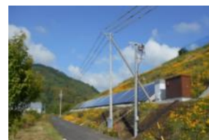
新丹谷太陽光発電所
