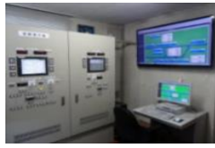
管理システムの設置 (富士宮市大倉川ダム地区)
