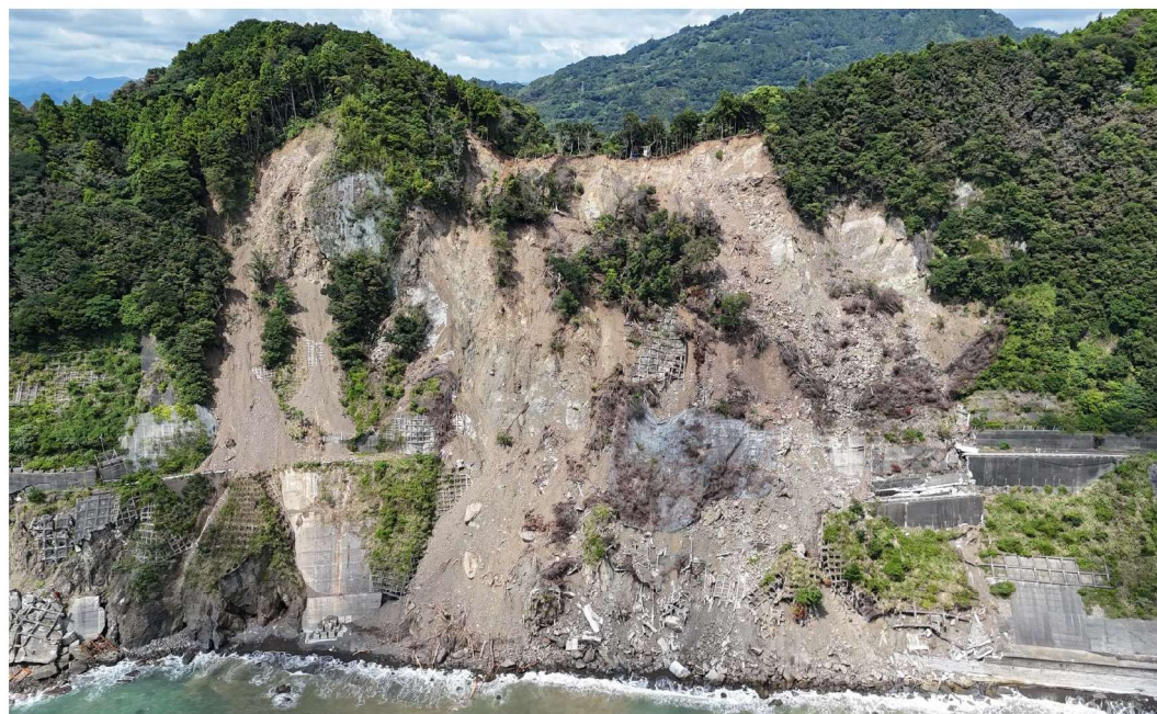
斜面崩壊全景 （R6.9.4撮影）
