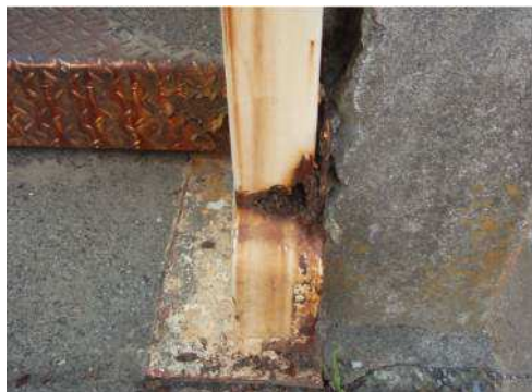
橋台接合部の腐食
