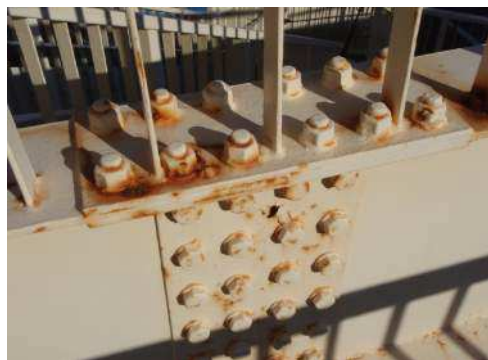
主桁接合部の錆び
