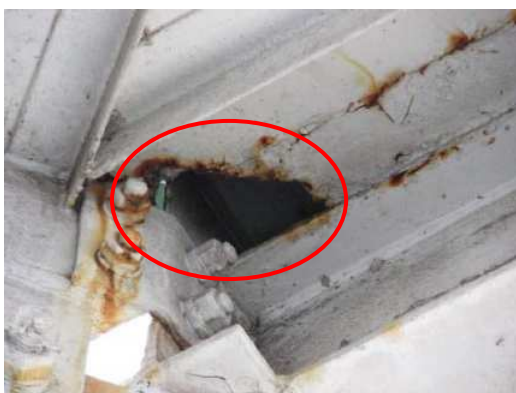
写真 4-3 鋼材の腐食による落下
