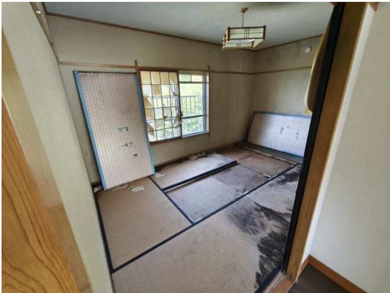
室内の状況(特に劣化等が著しい部分を抜粋)
