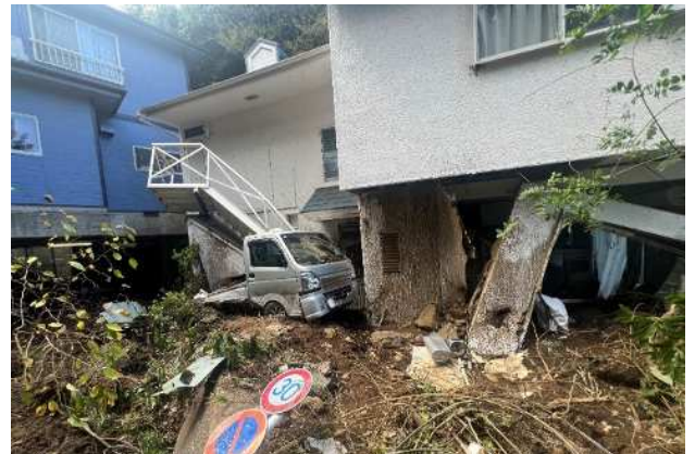
崖崩れによる家屋損壊(伊東市)
