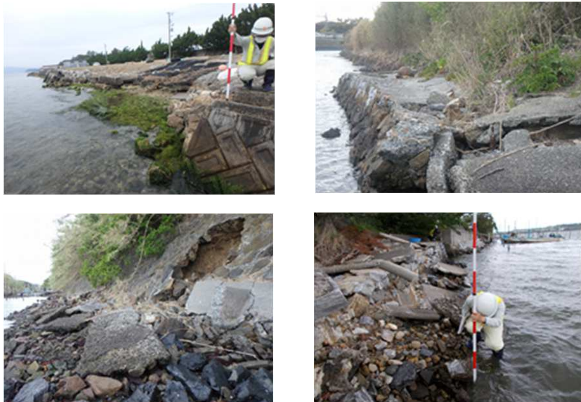
図 3.5 老朽化した湖岸堤
