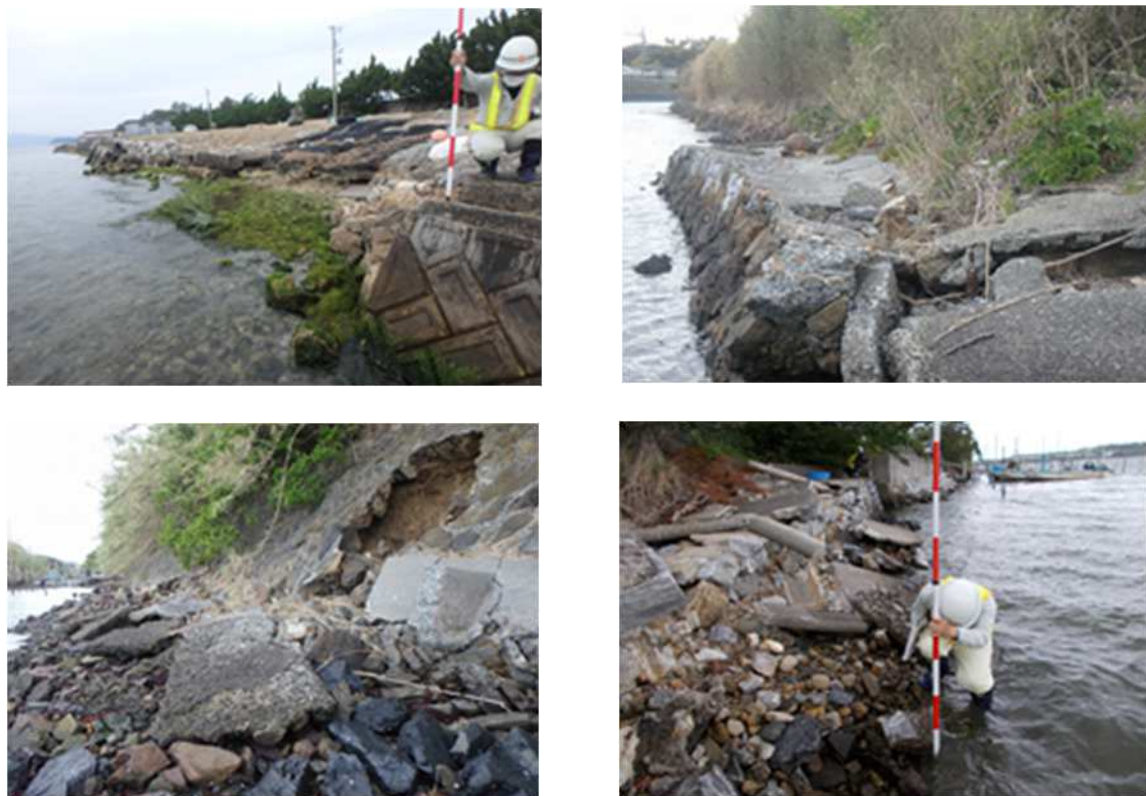
図 3.4 老朽化した湖岸堤
