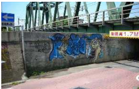
図 2-53 護岸への落書き -JR 橋付近-
