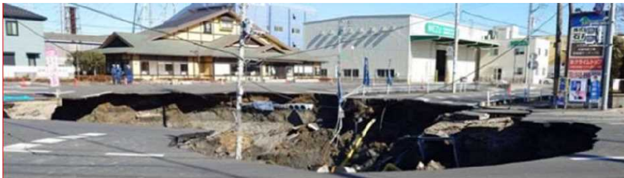
出展:埼玉県危機対策会議(流域下水道管の破損に起因する道路陥没事故)
