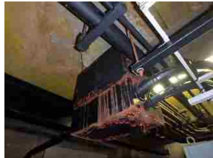
○設備の老朽化
