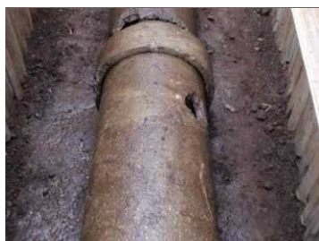
老朽化した管水路
