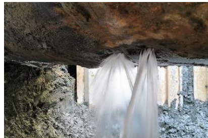
漏水箇所（腐食孔）
