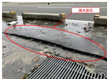
漏水状況（地表面）
