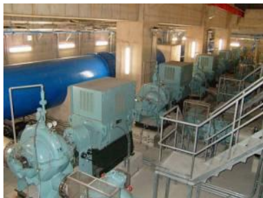
取水・送水ポンプ
