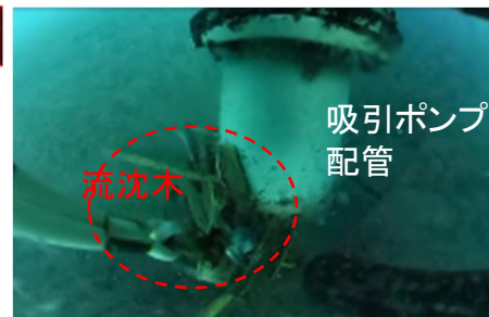
流沈木による土砂吸引の障害を確認
