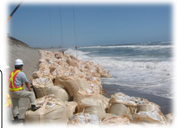
写真 新居海岸の侵食状況（2002(H14)年）
