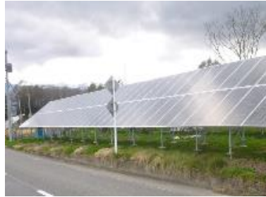
柵塀の設置されない設備
