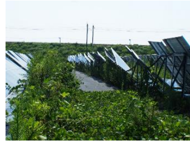
不十分な管理で放置されたパネル
