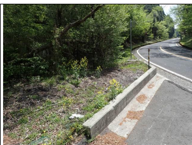
富士山スカイライン上り線区画No.63 (平成29年5月12日撮影)
