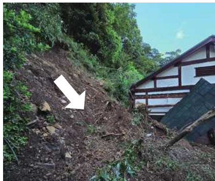
崩壊発生状況
