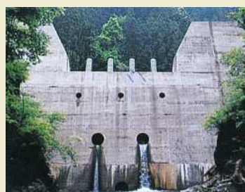
天竜川水系 出馬川 (浜松市天竜区佐久間町) 静岡県初めての鋼製スリット堰堤 (昭和57年)
