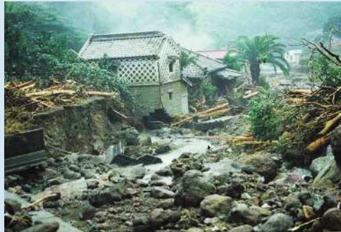
土石流によって削られた土地と土砂流入した人家（河津町）
