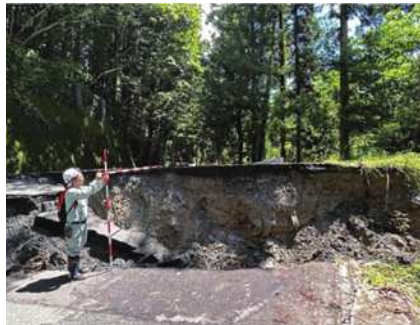
斜面上部の道路被災状況
