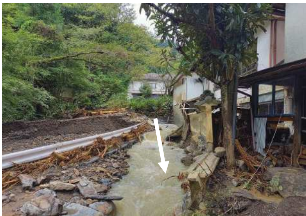
油山川土砂流出状況
